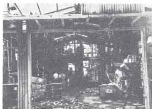
全焼した危険物製造所の内部
