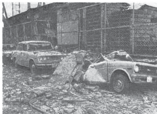
爆発で吹き飛んだコンクリート壁で、路上の車がベ チャンコ
