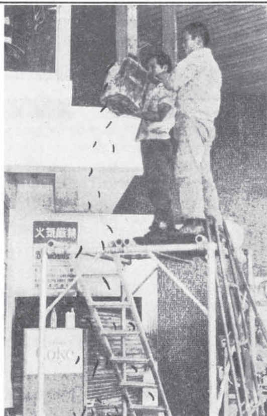
石油天切岳で火花をうけて熔接したが飛散する火花でポンプ室より流れたガソリン蒸気に引火
