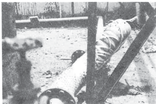
【ブレードが破れたフレキシブルチューブ】
