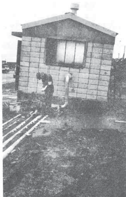
出光興産青森油槽所の泡消火栓用ポンプ室、配管部が破損
