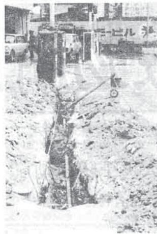
写真1 掘り出されたパイプ
