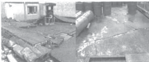
破損状況(消防庁)
