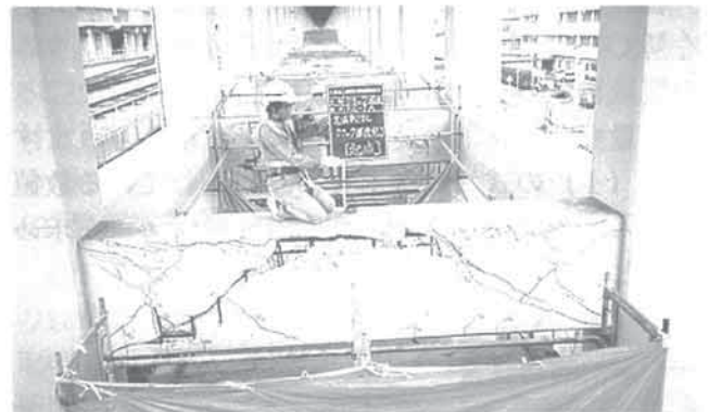
画像① 山陽新幹線高架橋中層梁クラック調査
