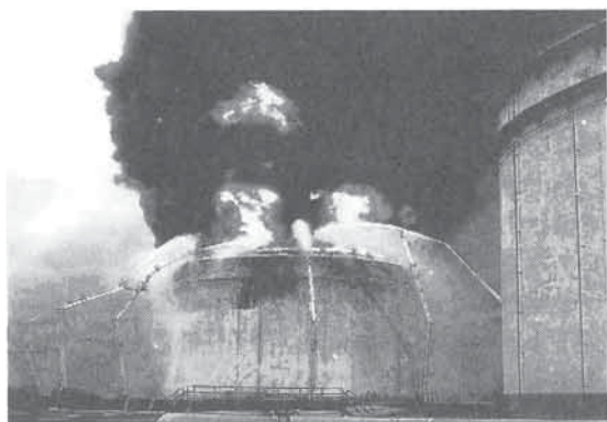
H15年9月、十勝沖地震で全面火災を起こした屋外タンク
