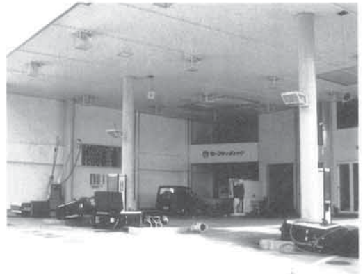
スタンド式計量機が横倒した給油所
