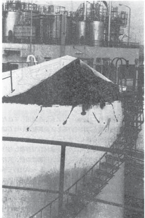
(写真) 爆発によりポッカーリ開いたタンクの天蓋、A、Bはこの上で熔接作業をしていた。
