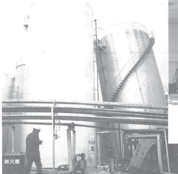
▼ 傾いた油タンク。
