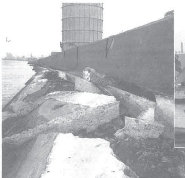
▲ 淀川河口の岸壁が倒壊する。
